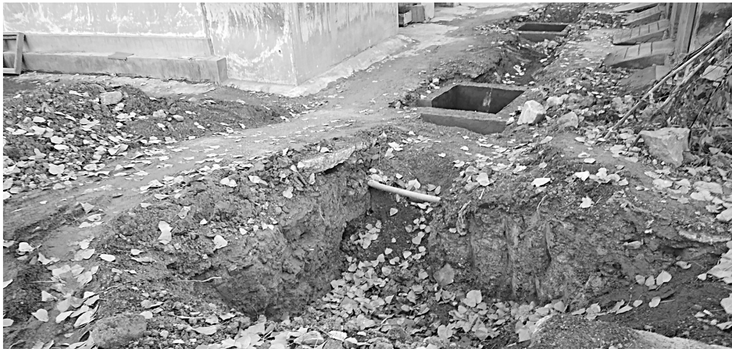
挖开的深坑迟迟不见填平,居民很是焦急
