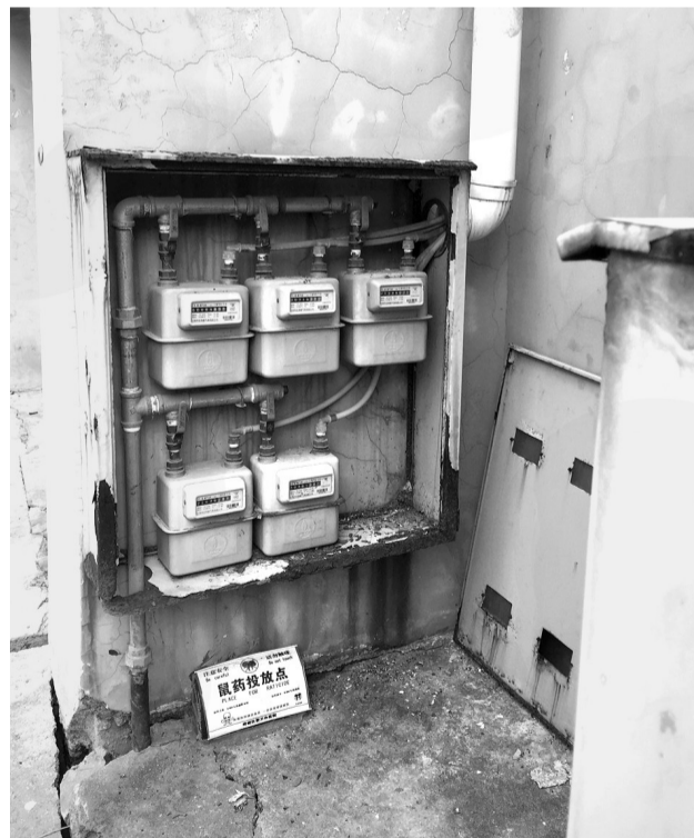
在峰城区金牛二期小区内,有两处年久失修的燃气表箱老化严重,多个燃气表暴露在外存安全隐患。“假期里,孩子们经常在小区内玩耍,要是孩子触碰燃气表,那么后果不堪设想。”一位小区居民说。(记者 安卿超 摄)
