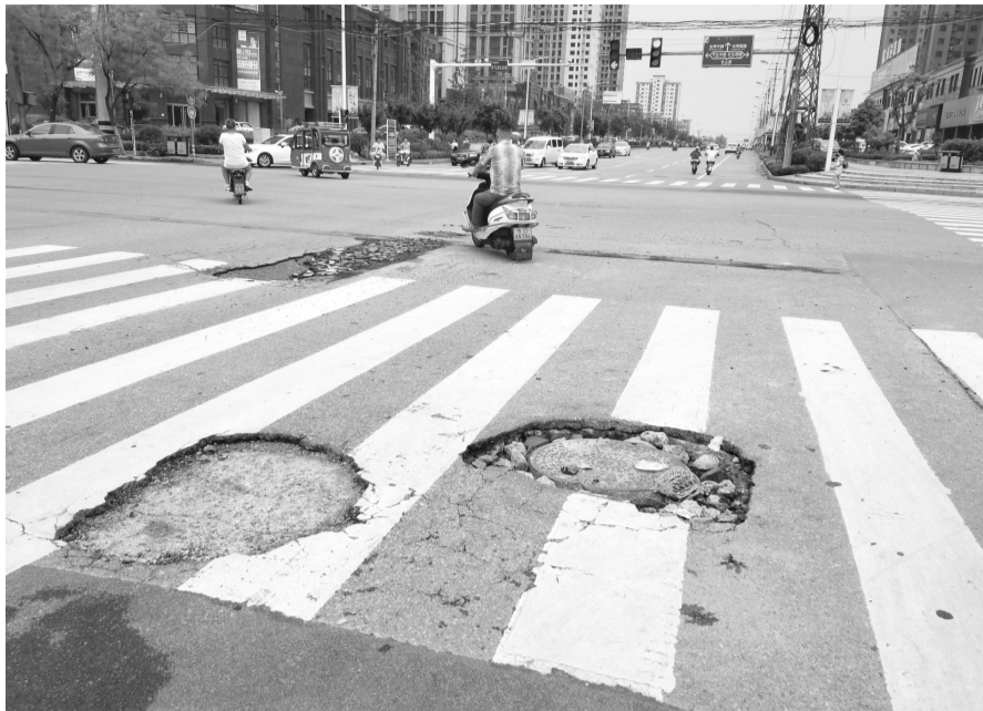
路口大坑给市民通行造成困扰
