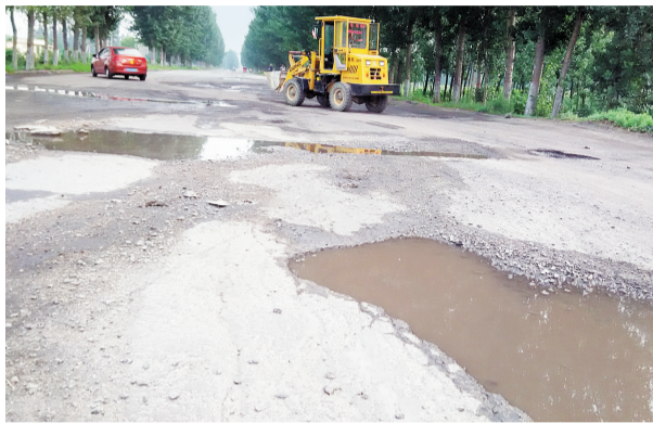
道路破损严重
