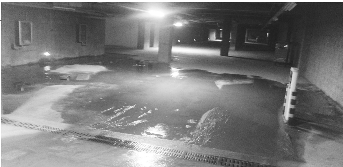
地下车库内也是污水遍地
