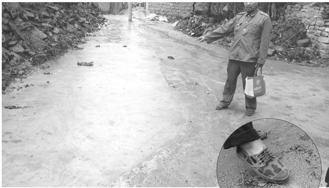
轻轻一撮,水泥路面便露出了沙土
