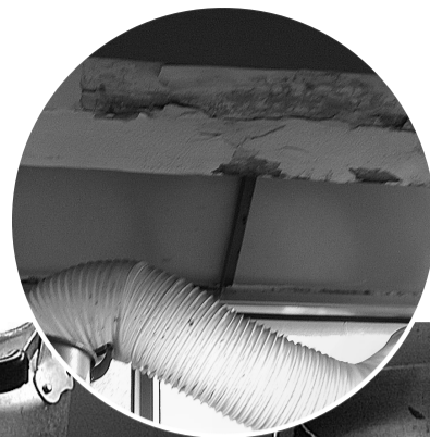
厨房屋顶的防水漆不断脱落,让吴女士很心烦。
