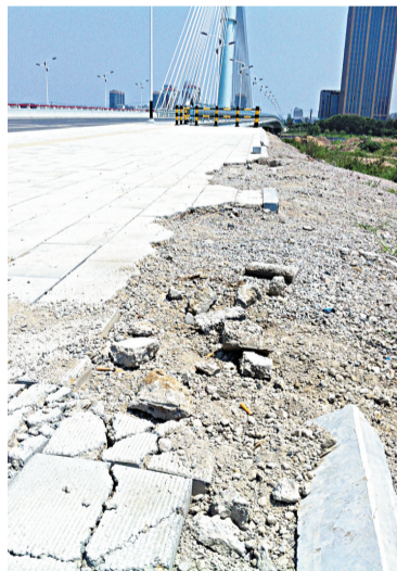
破损的路面与远处气派的大桥格格不入
