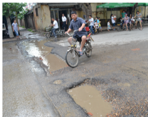
青檀北路枣矿集团医院墙西的路面上,两年前维修管道时被横着挖开了一道沟,路面虽经修补,但现在损坏严重,车辆行人途经此处经常发生事故,市民们希望相关部门能尽快对其进行维修。(记者 孔浩 摄)
