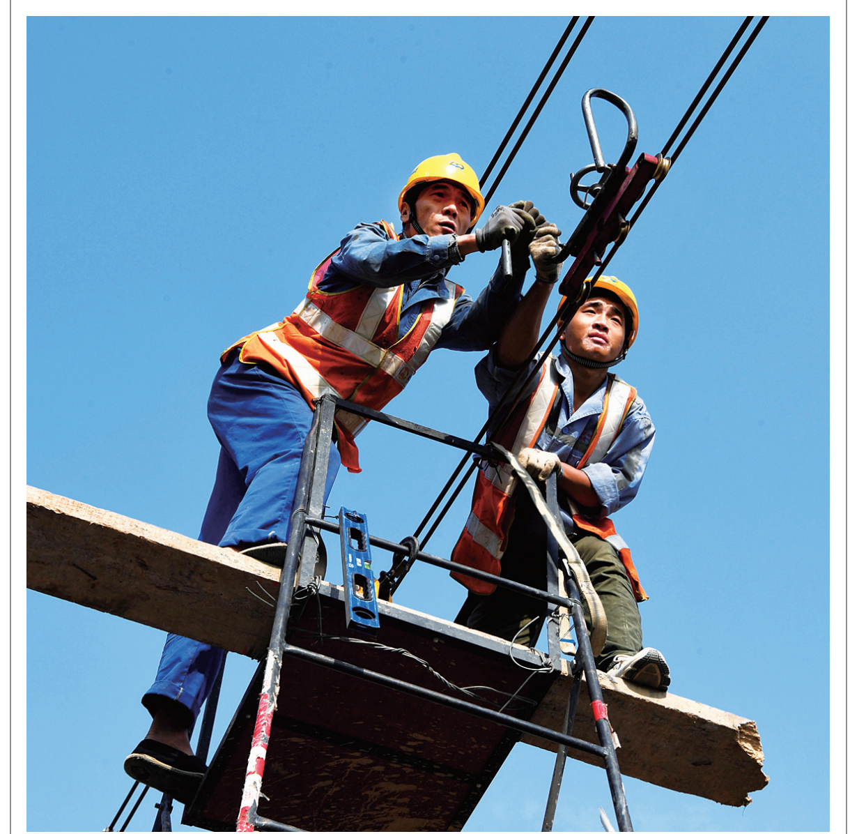
坚守岗位过中秋 9月24日,中铁电气化局的工作人员在郑州轨道交通5号线五龙口停车场进行作业。当日,在郑州轨道交通5号线施工现场,中铁电气化局的工作人员坚守施工一线,在工作中度过中秋佳节。(新华社发)
