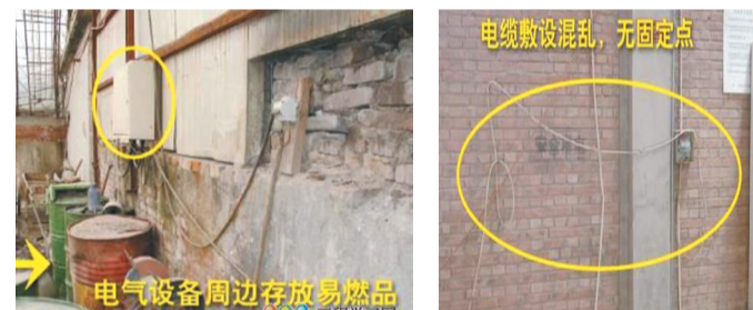
电气设备周边存放易燃品
