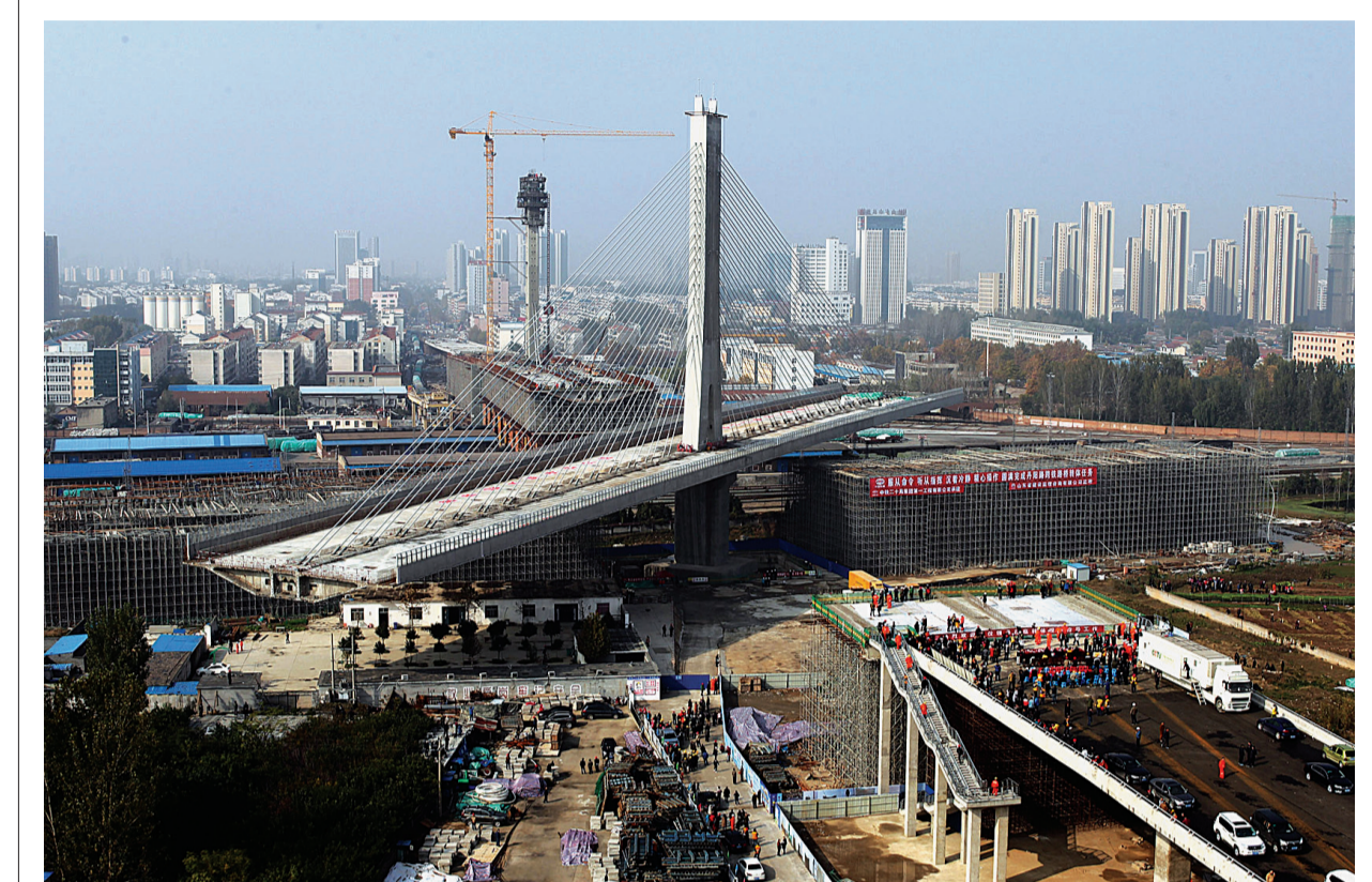
这是11月8日拍摄的山东菏泽丹阳路立交桥转体工程现场。当日,在两台350吨连续式千斤顶的牵引下,自重达2.48万吨的山东菏泽丹阳路立交桥东侧主桥逆时针转动81.67度,与引桥实现精准对接。至此,当今世界转体重量最大的斜拉桥成功“转身”。
