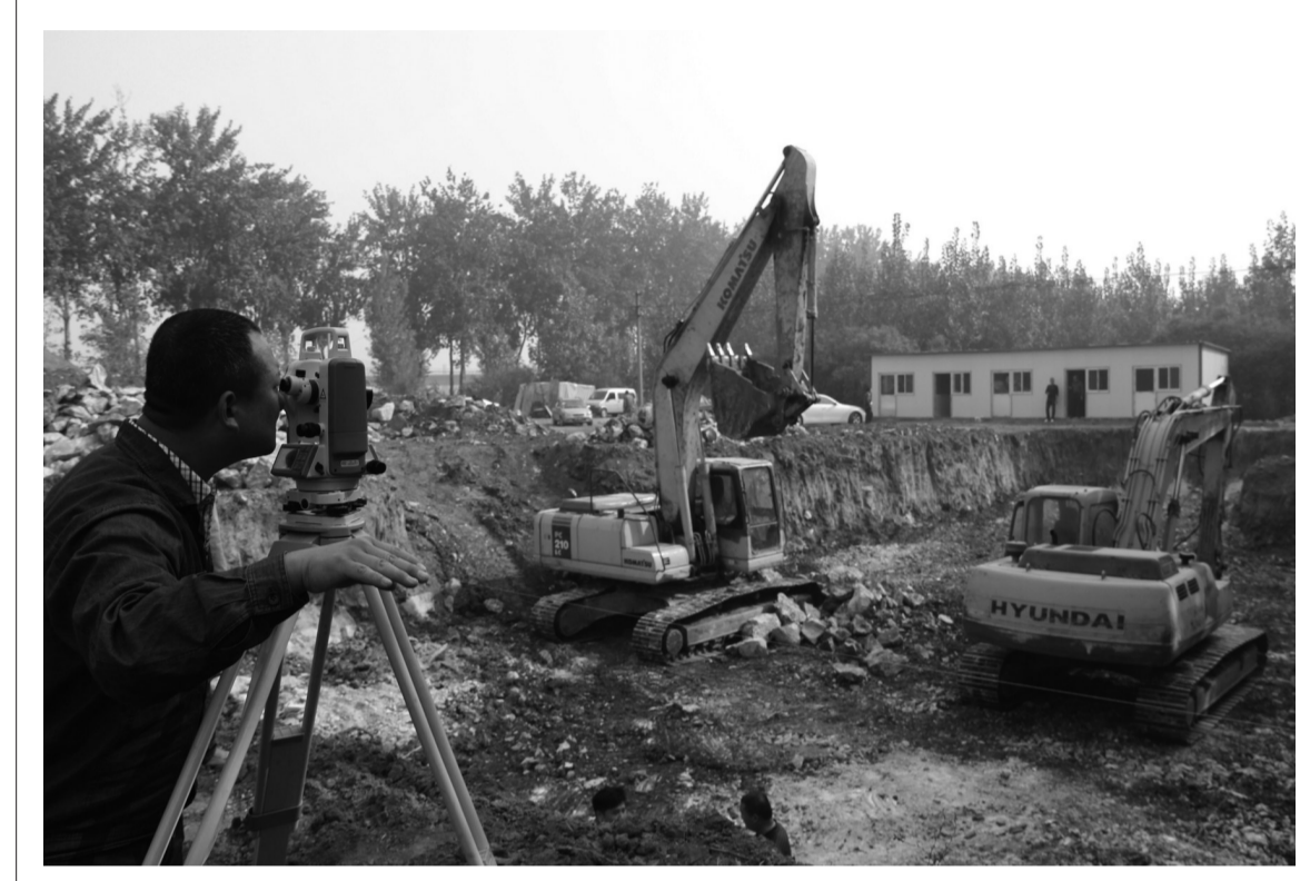
近期，投资800多万元的我区农村饮水工程税郭水厂正式开工建设，水厂的建立将惠及该镇12个村及镇驻地1万余人。
