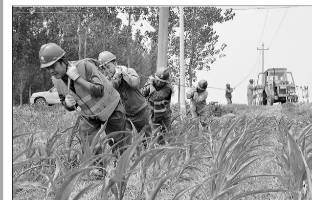
7月8日,枣庄供电公司峰城客户服务中心按计划对35千伏14#古邵线实施停电,顺利完成该线一条分支线1-20#杆绝缘导线更换,大大提高了线路安全运行水平,为该沿线4个用电村500余户居民安全可靠供电夯实了基础。图为该中心施工人员现场放线的施工场景。(王维涛 摄)
