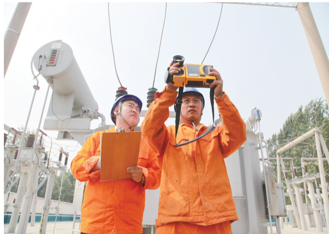
为保障夏季电网安全可靠运行,薛城供电服务中心根据夏季天气变化情况,及时组织技术人员采用特巡、夜巡、红外线测温等方式对所辖的输、变、配设备进行巡查、消缺,确保供电设备“零缺陷”运行。(吴超 摄)
